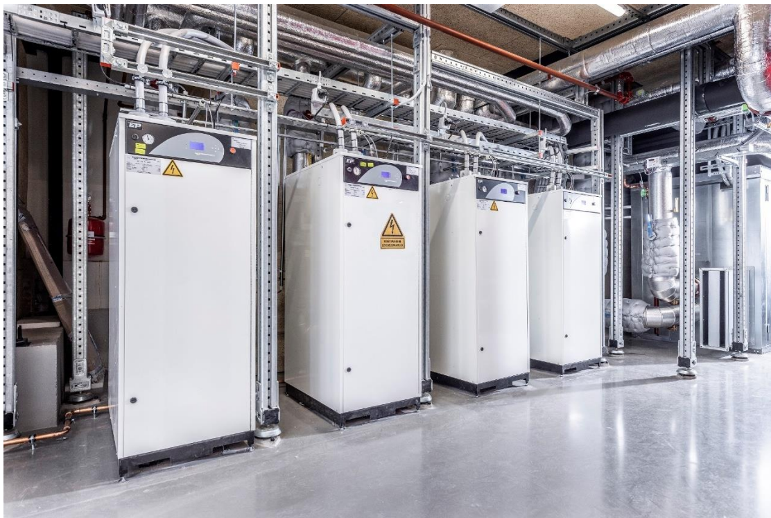
Referentie E-ketels project monumentaal kantoor den Haag, realisatie Kuipers
